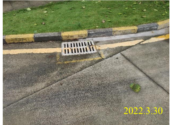
项目雨水井盖
