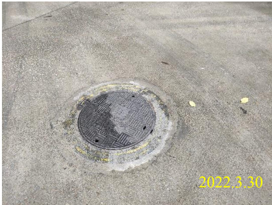
项目污水井盖
