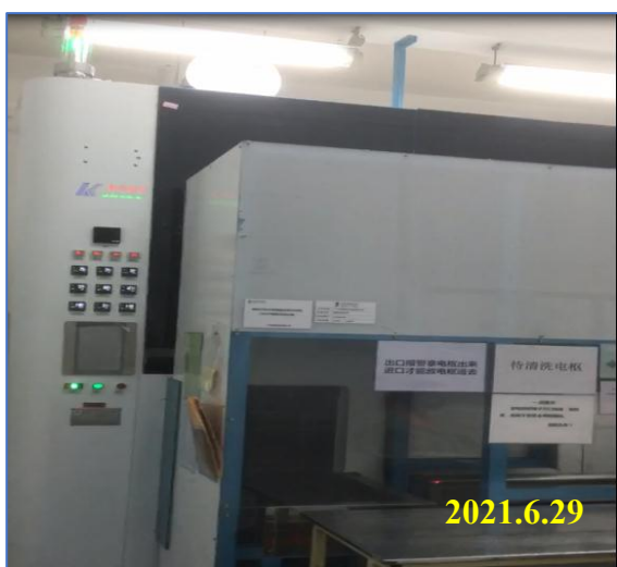
新增碳氢清洗设备
