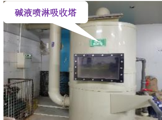
项目碱液喷淋吸收塔
