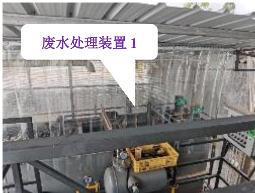
项目废水处理设施 1
